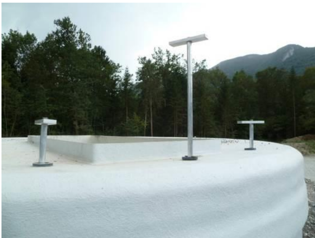
Poignées de sélection manœuvrable de l'extérieur de l'ouvrage de stockage
