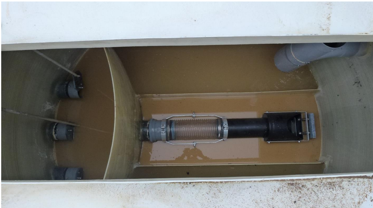
Vue de dessus cloison posée avec les équipements installés : Mobile de chasse pendulaire et système de répartition intégré (RVI)
