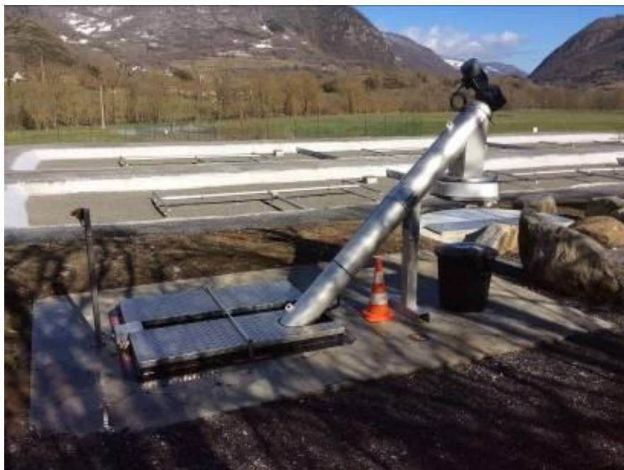
Ouvrage de dégrillage à vis avec secours manuel de secours.
