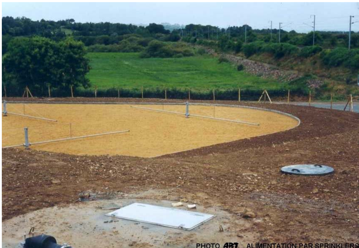
PHOTO ABT ALIMENTATION PAR SPRINKLERS
