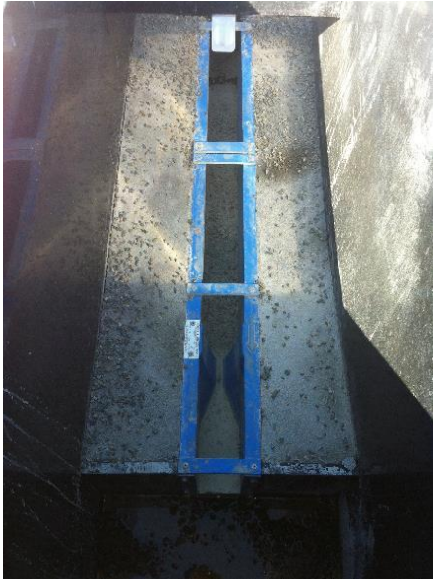
Canal Venturi Type I dans un ouvrage 1500
